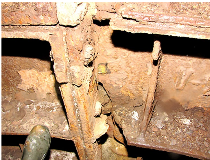
Рис. 1. Разрушение ребра тюбинга со смещением
