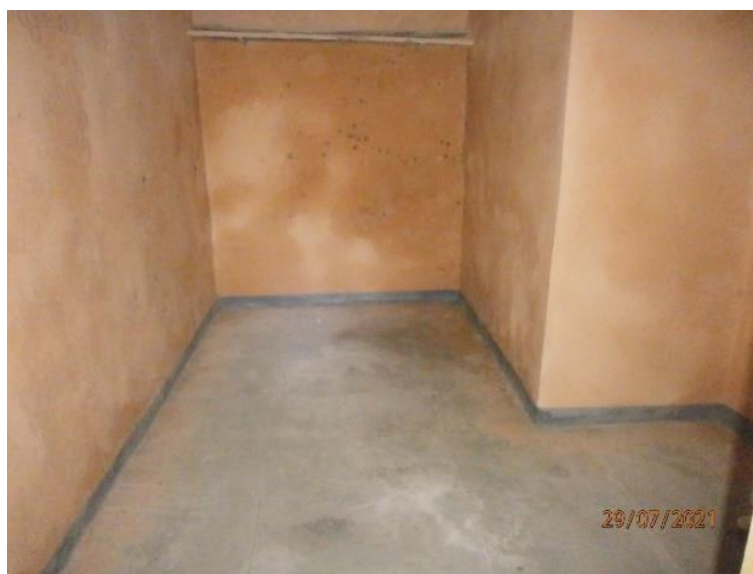
Рис. 4. Дефект, переувлажнение помещения
