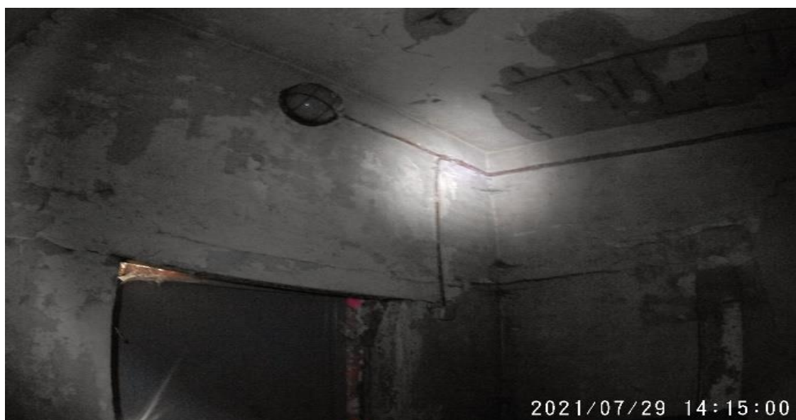
Рис. 1. Дефект, выщелачивание бетона
