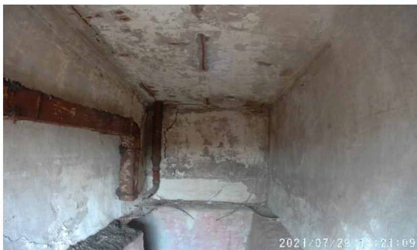
Рис. 2. Дефект, коррозия арматуры
