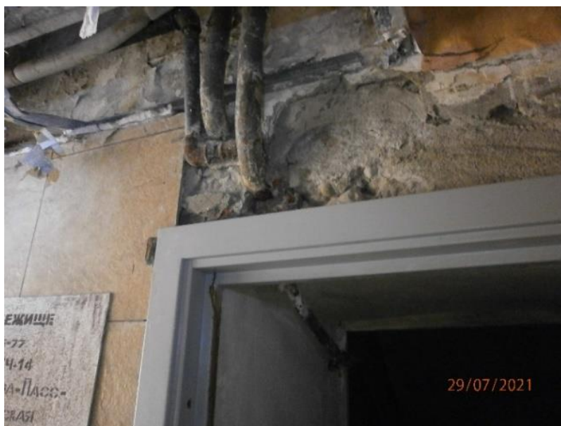
Рис. 3. Дефект, влияние переувлажнения на материалы отделки
